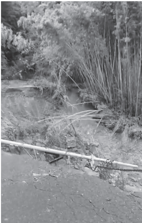
大津地区の道路崩壊 (令和2年)
