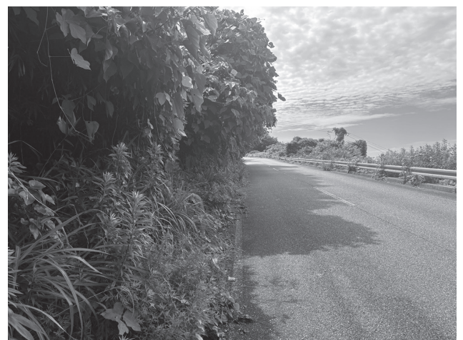
通行の支障となる草木（蒲井へ続く県道）
