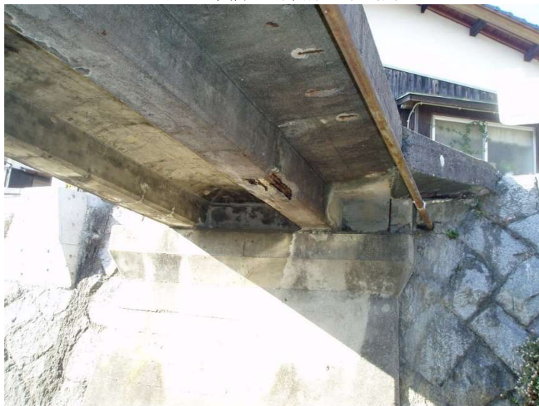
写真 1.2.1 主な損傷写真-1
