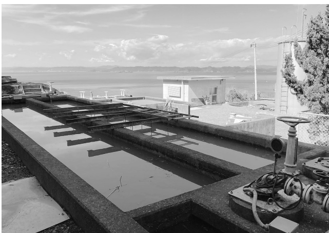
老朽化が進む祝島浄水場
