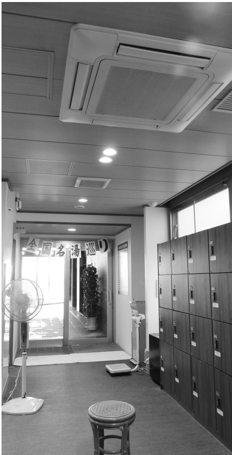
修繕予定の「鳩子の湯」の空調設備
