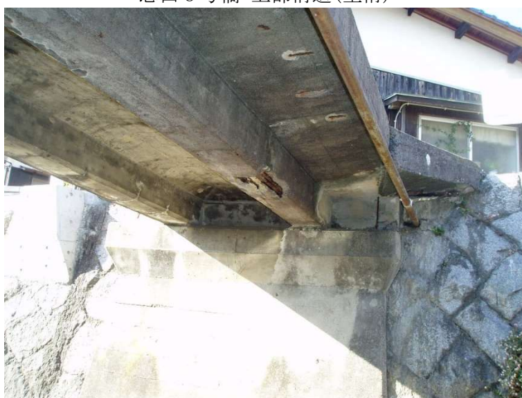
写真 1.2.1 主な損傷写真-1
