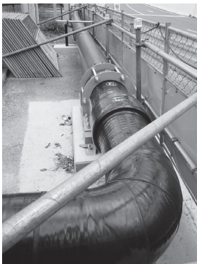
周防大島大橋の仮設水道管
