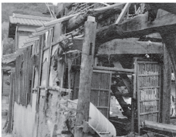
解体がまたれる空き家
